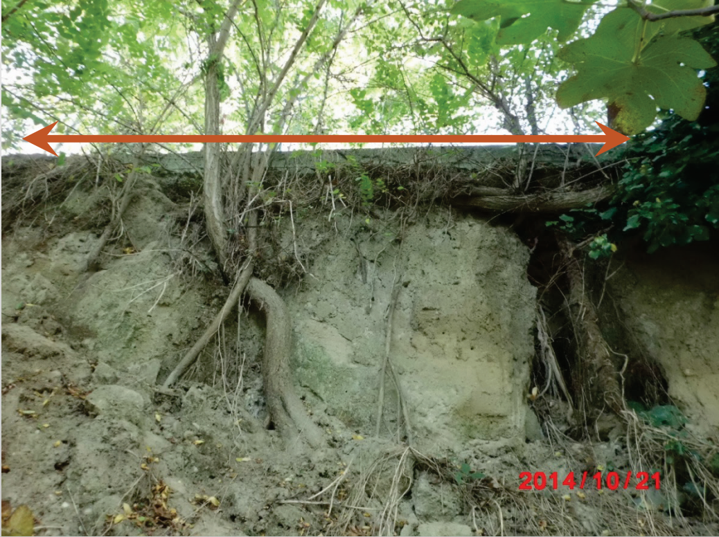
2014 Uferabbruch im Hausgarten; braune Linie ist das Mäuerchen im linken Foto
